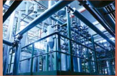
Particolare dell'impianto produttivo di Arco (Trento).
