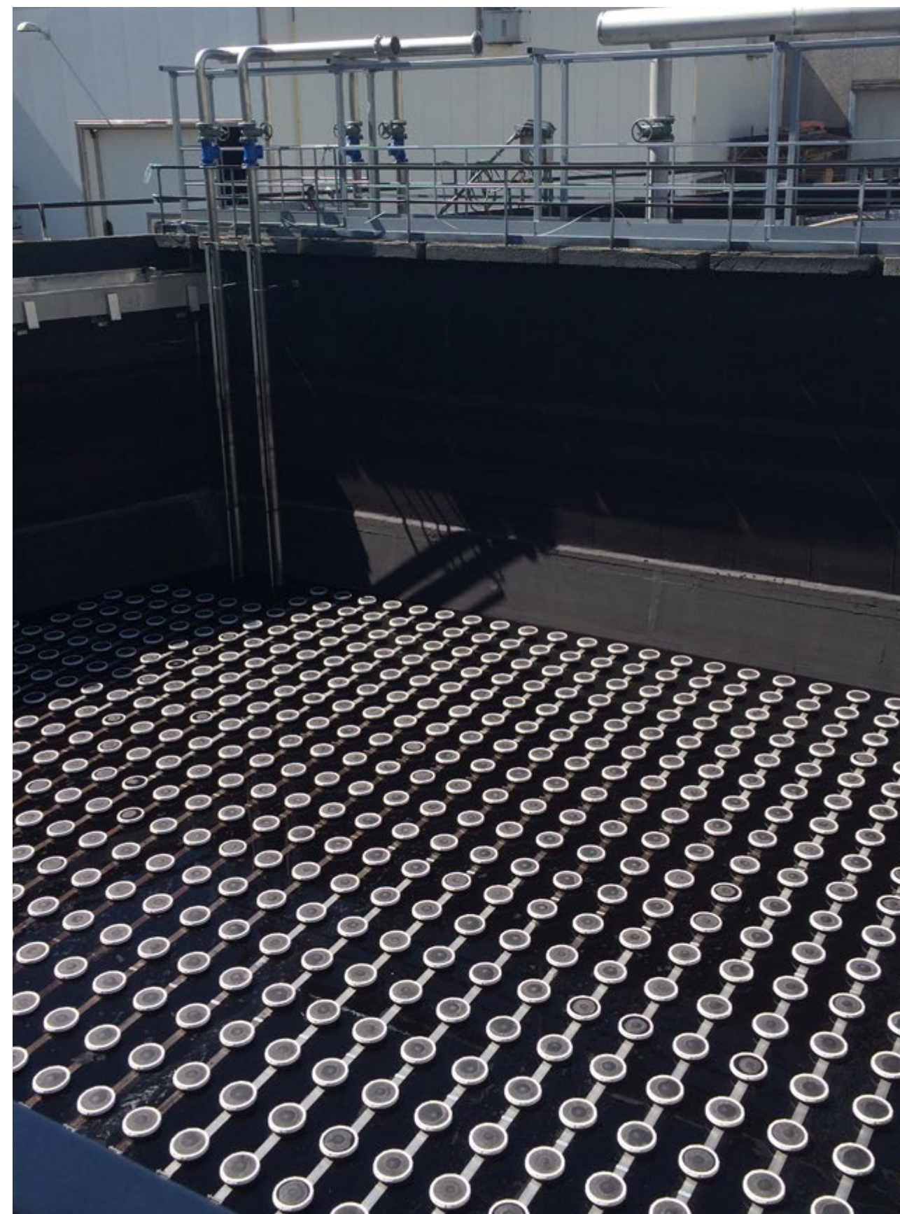
Vasca di ossidazione per depurazione aerobica presso Aquaspace (Rovereto, Italia)
